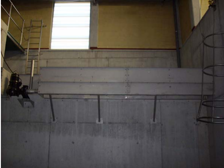
Tanques de Tormenta en Lugo Colectores Generales del río Miño
