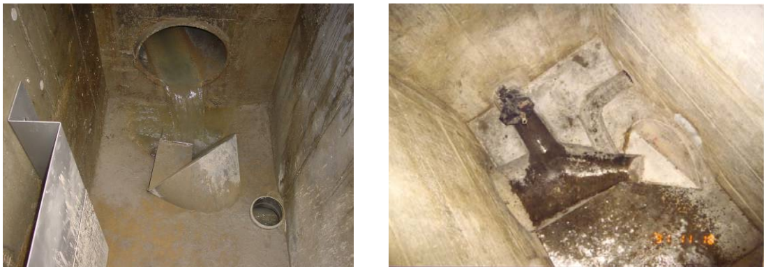
Figura 10: Instalaciones en cámara húmeda.
