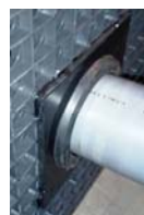
Pièce de connexion des tuyauteries
