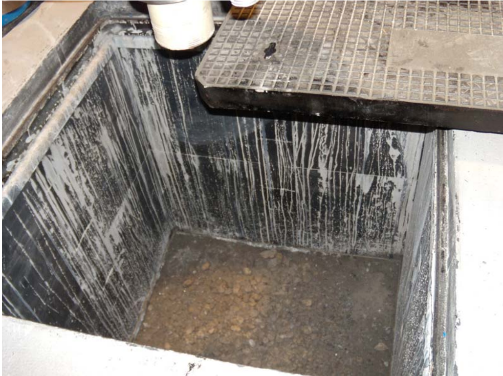
Interior arqueta tras aplicar la carga de 16.500 kp.
